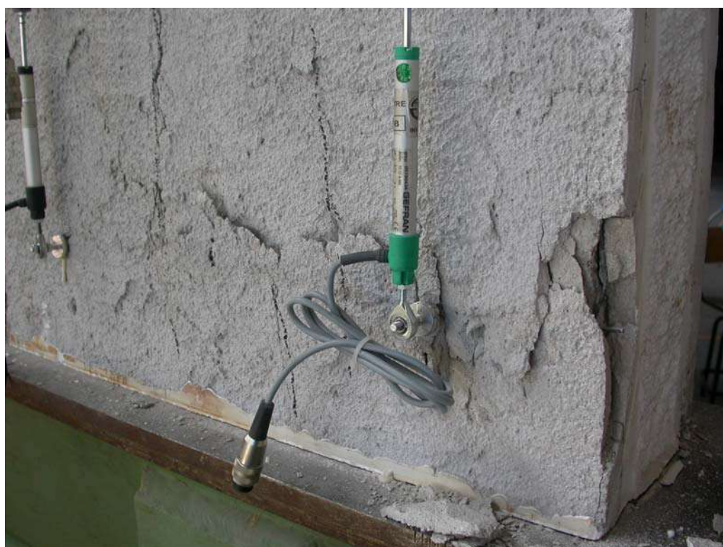
Figura 15: Rottura per compressione del calcestruzzo
