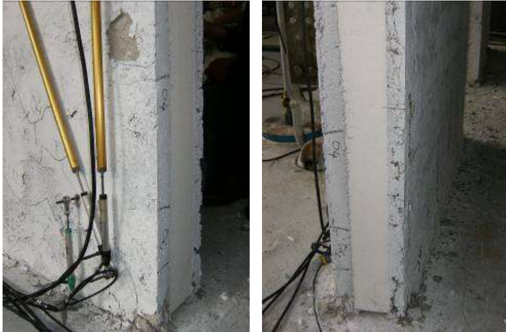
Figura 70 Danneggiamento al termine dell'imposizione dei tre cicli a livello di drift 1.0% (lungo lo spessore del muro)
