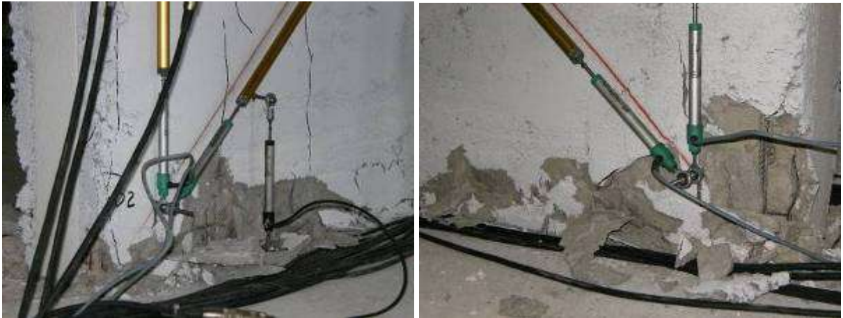
Figura 23 Danneggiamento al termine dell'imposizione dei tre cicli a livello di drift 1.0%
