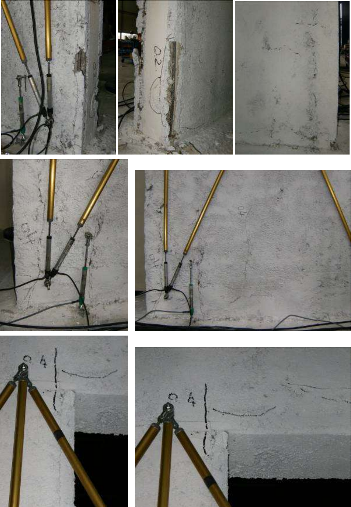
Figura 76 Danneggiamento al termine dell'imposizione dei tre cicli a livello di drift 0.4%
