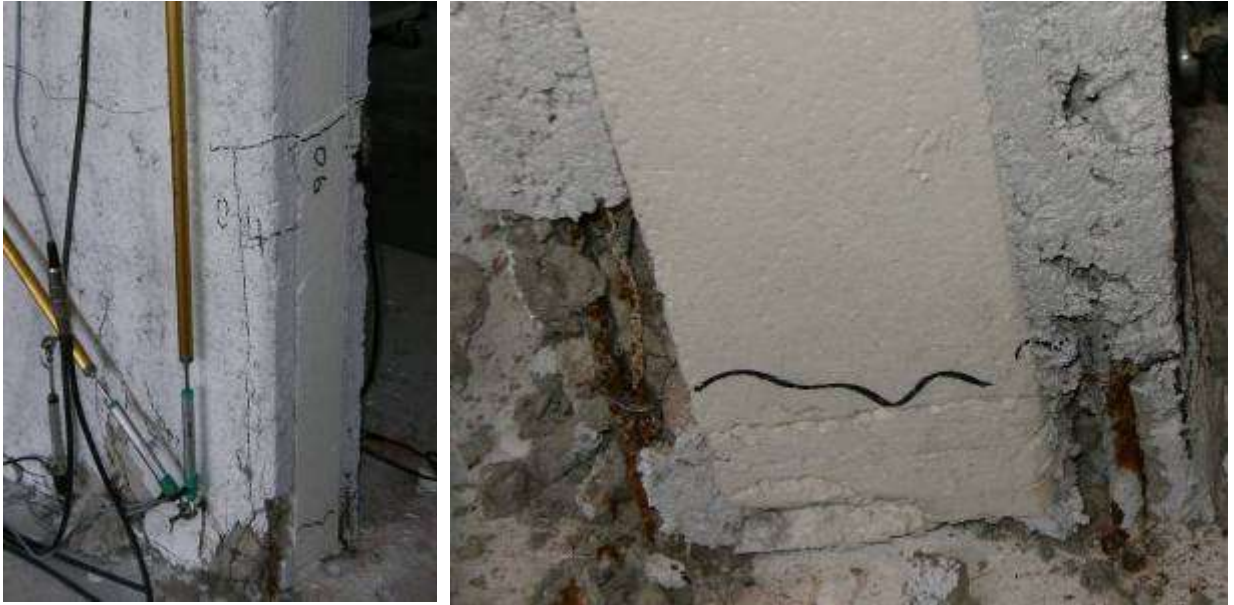
Figura 15 Danneggiamento al termine dell'imposizione dei tre cicli a livello di drift 0.6%: quadro fessurativo sullo spessore e rottura per compressione in corrispondenza dello spigolo inferiore
