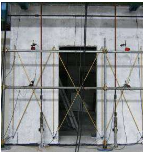
Figura 64 Danneggiamento al termine dell'imposizione dei tre cicli a livello di drift 0.1%
