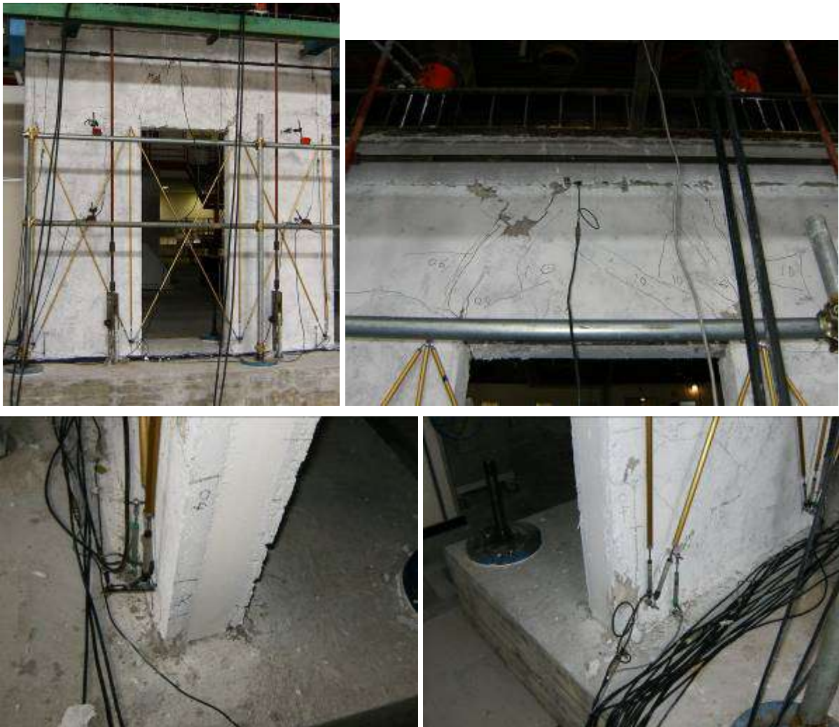
Figura 71 Danneggiamento al termine dell'imposizione di un ciclo di carico e scarico a livello di drift 1.5%
