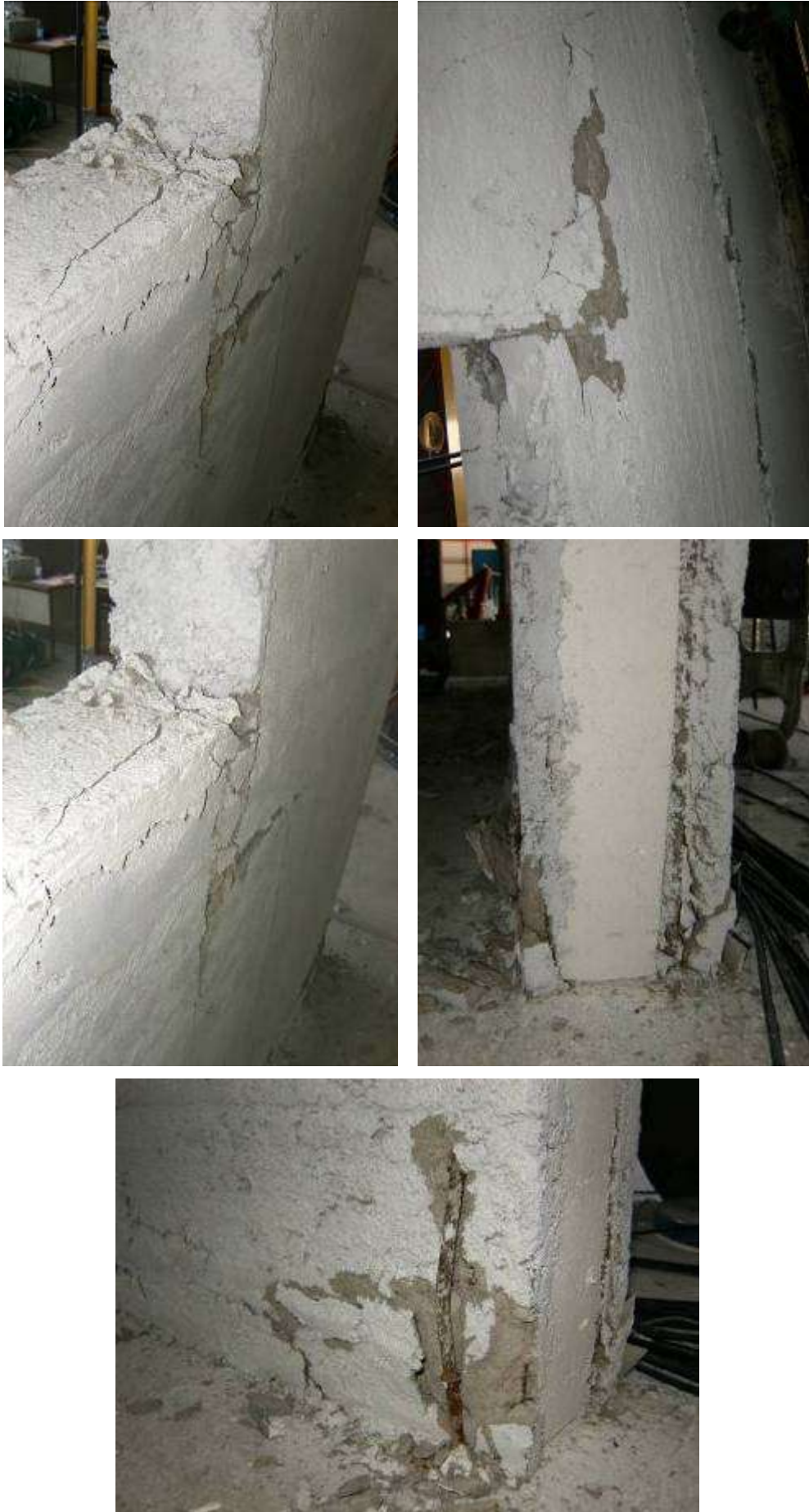
Figura 57 Danneggiamento al termine dell'imposizione dei tre cicli a livello di drift 1.0%
