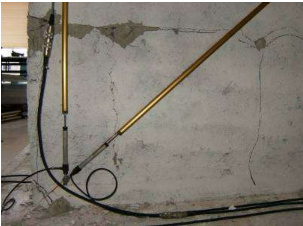
Figura 16 Danneggiamento al termine dell'imposizione dei tre cicli a livello di drift 1.0%
