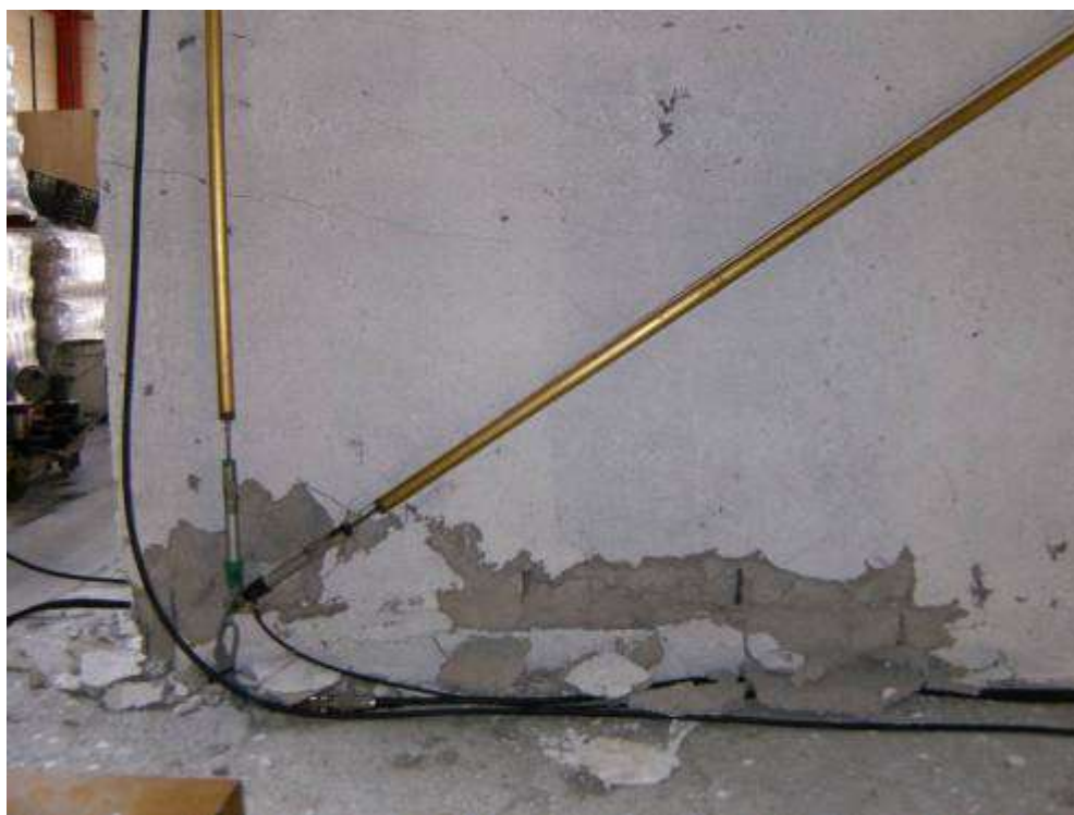
Figura 40 Danneggiamento al termine dell'imposizione dei tre cicli a livello di drift 0.6%
