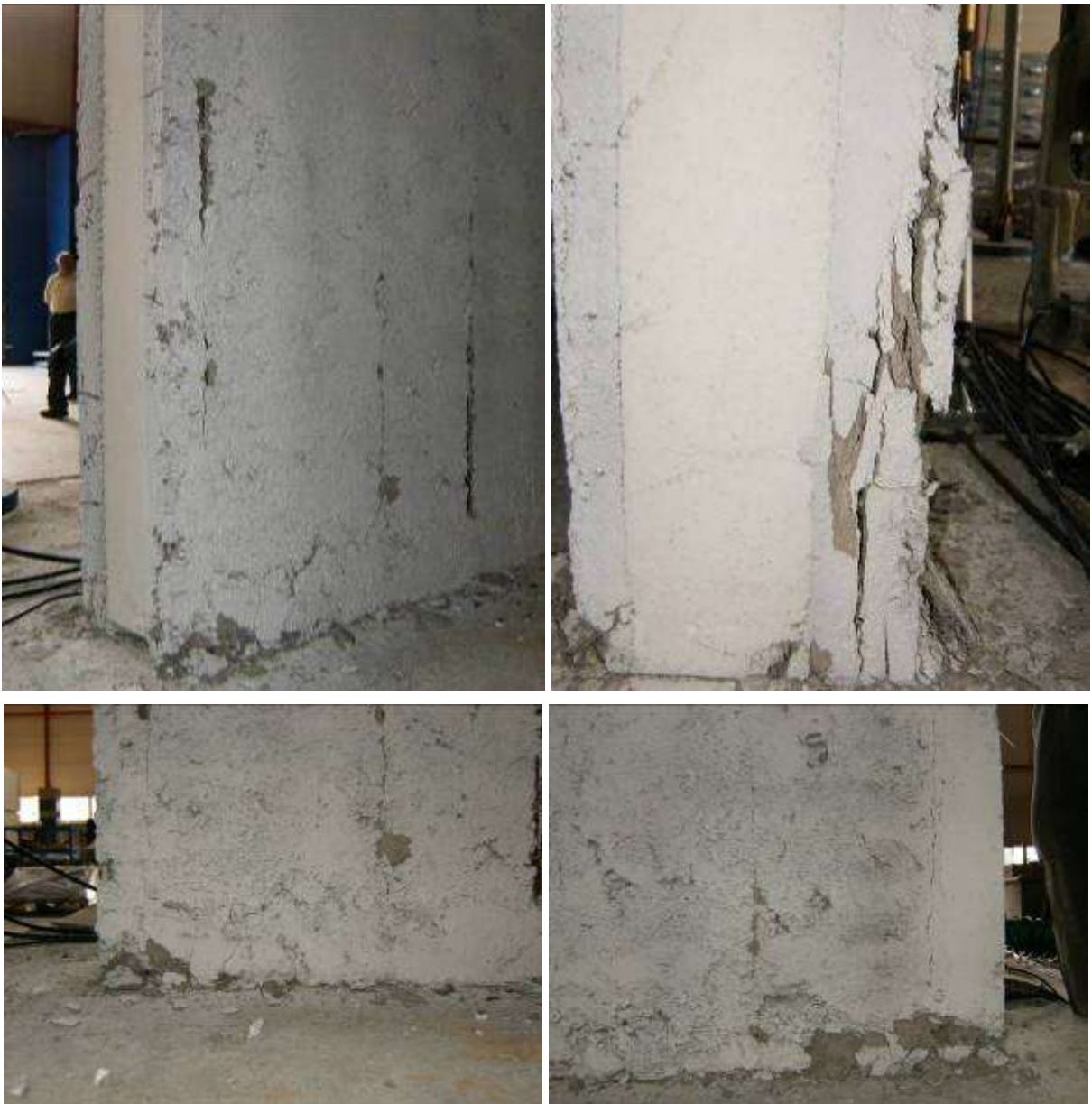
Figura 69 Danneggiamento al termine dell'imposizione dei tre cicli a livello di drift 1.0% (in corrispondenza della base)
